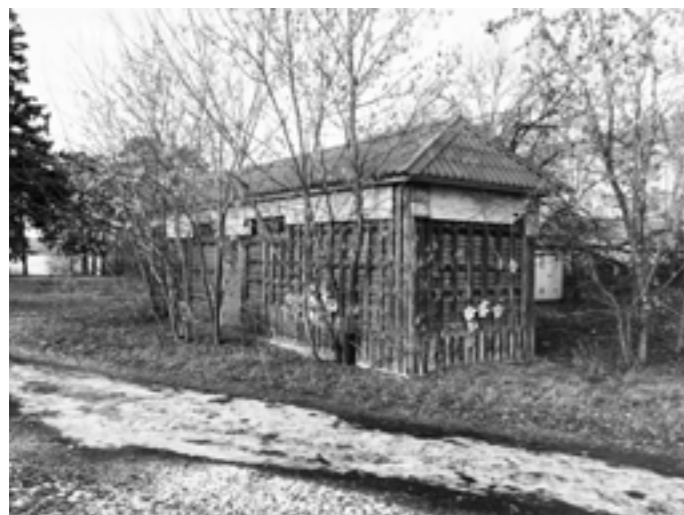
9 Требующие ремонта сооружения коммунальных служб
