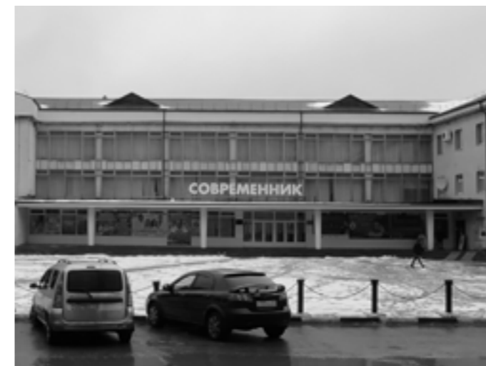
11 Реконструкция здания ДК с изменением стилистики, повреждения фасада
