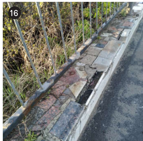
16 Разрушение подпорной стены.
