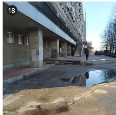
18 Плохое состояние покрытия.
