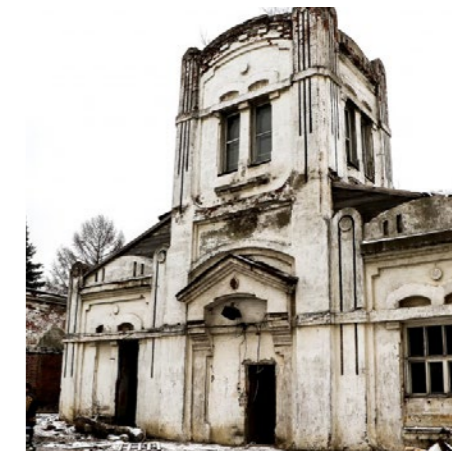
6. Ярмарочная водозаборная станция ул. Стрелка, 21в, литеры А, А1
